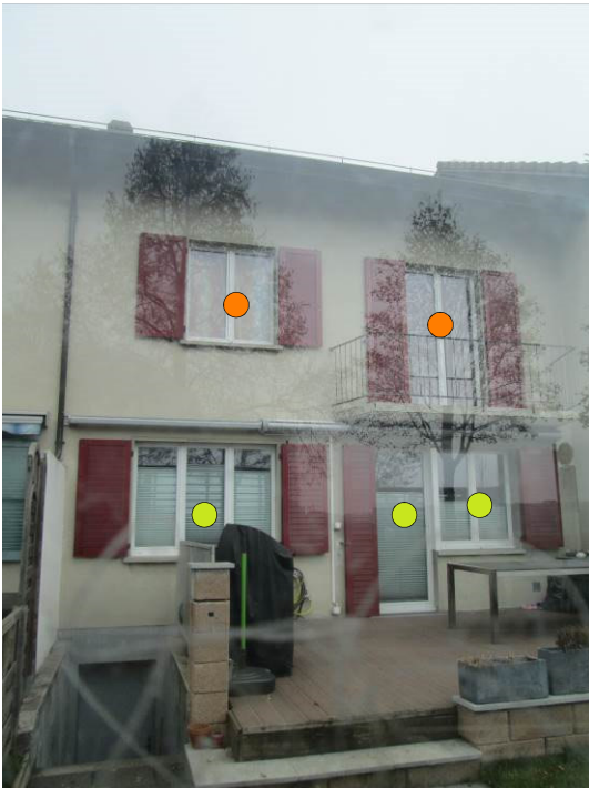
Südwestfassade (einzige Fassade mit Überschreitungen)
