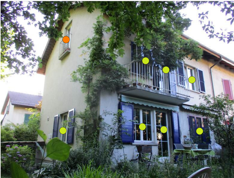
Nordwestfassade / Südwestfassade (die übrigen Fassaden ohne Überschreitungen)
