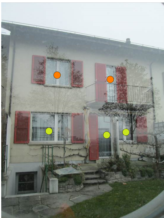
Südwestfassade (einzige Fassade mit Überschreitungen)
