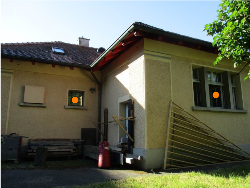
Nordwestfassade (die übrigen Fassaden weisen keine Überschreitungen auf)
